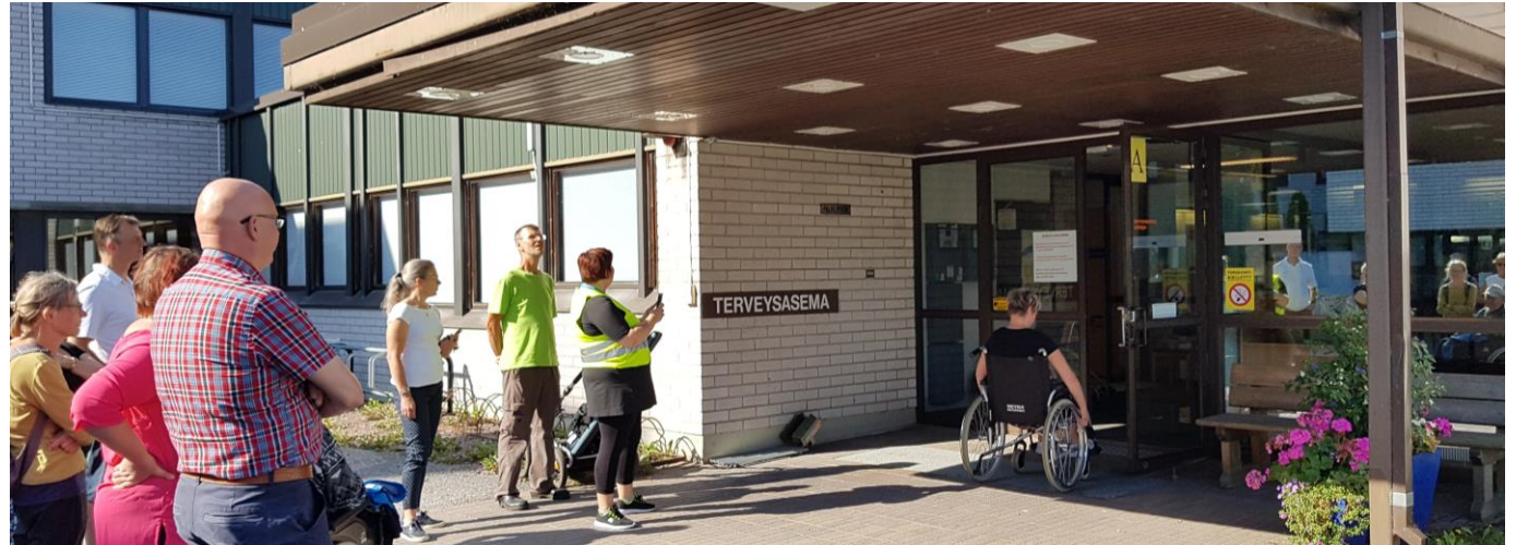
PÄÄSISÄÄNKÄYNNIN ESTEETTÖMYTTÄ HEIKENTÄVÄT OVIAUKON KYNNYKSET.
