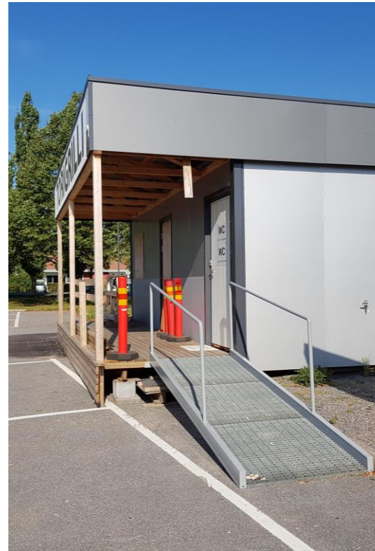
LUISKAN KALTEVUUS ON 17,5 %, MUTTA ALAREUNASSA ON PUTOAMISESTEET.
